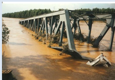
Antiguo puente de hierro arrastrado por la corriente del río Odiel. Foto: Paco Marco.
